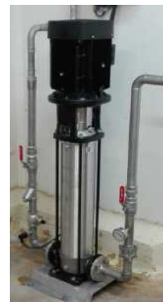
Pompe pour le pré-lavage / Rinçage
